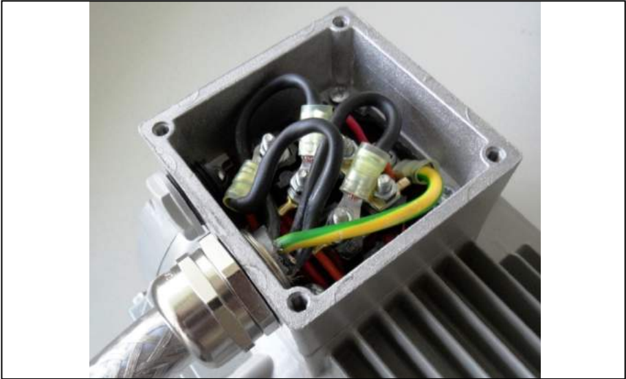
Abb. 26: Verdrahtung am Motoranschlusskasten
