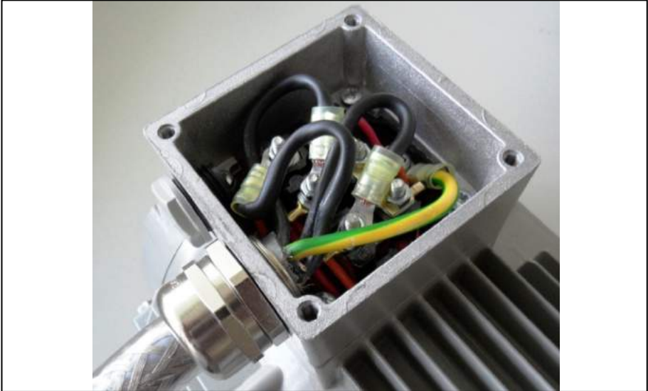
Abb. 22: Verdrahtung am Motoranschlusskasten
